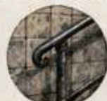
原金屬扶手與磨損
