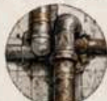
外露的管線與鏽蝕
