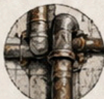
外露的管線與鏽蝕
